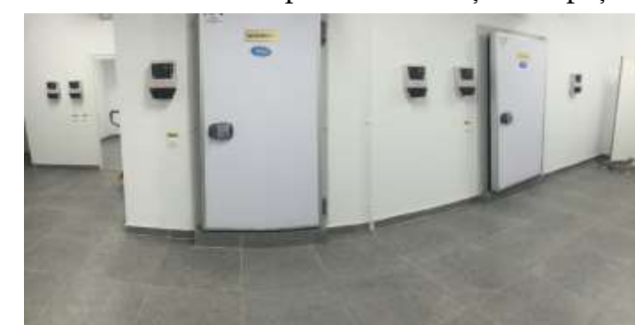
FOTO 80 - Zona depozitelor de refrigerare
