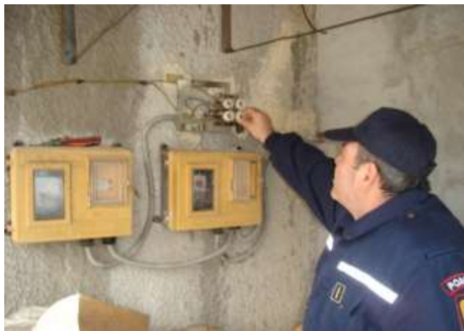
FOTO 73 - Verificarea instalației electrice într-o gospodărie
