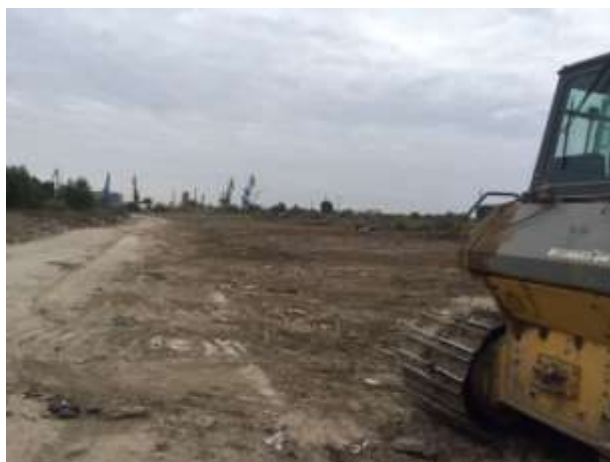
FOTO 103 - Aducerea la cota terenuri : zona de depozitare deșeuri inerte pe Platforma 1 Chimie;
